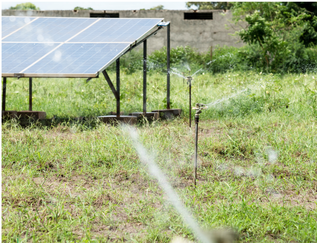
Panneaux solaires pour diminuer les charges de productions, 2 ha, Keur Samba Gueye, Sénégal
